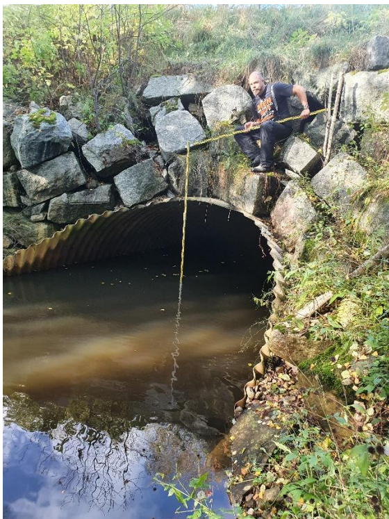
Figur 4 Vägtrumman under Sundsbrovägen, nedströms Ålsjöängarna där en av vattennivågivarna installerades. Vattenståndet när bilden togs är +10,62 m och trumman däms in helt vid vattenståndet +11,92 m.
